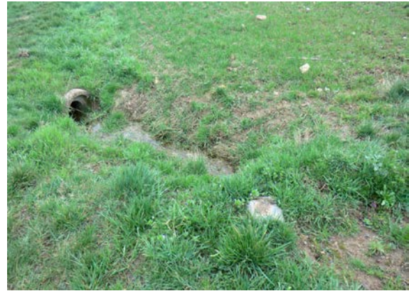
Abbildung 7 Wasserführung muss nachprofiliert werden
