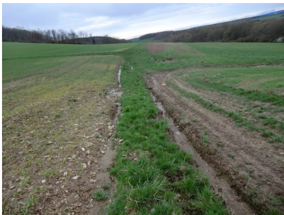
Abbildung 4 Wirtschaftsweg mit fehlender Wasserführung
