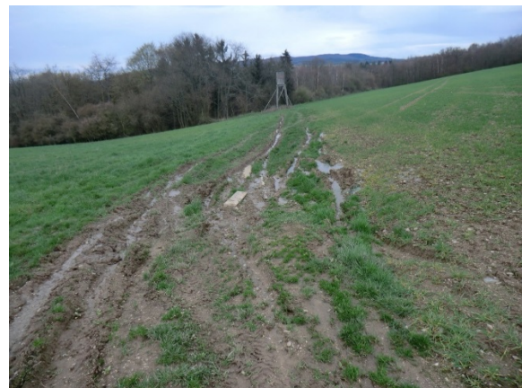
Abbildung 5 Wasserschäden am Wirtschaftsweg
